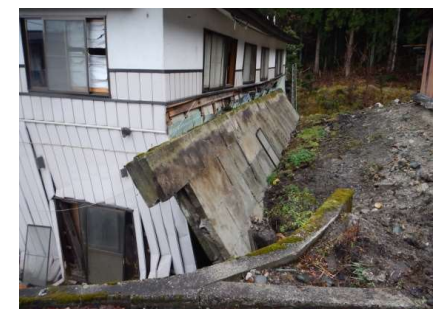
擁壁が倒壊して隣地建物を破損させているが、何ら支援はない
